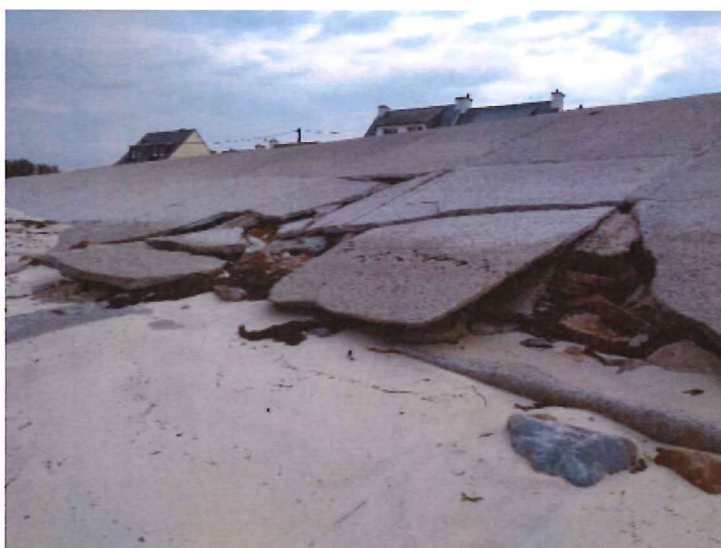
Figure 1 : Désordres sur l'ouvrage survenus au printemps 2018
