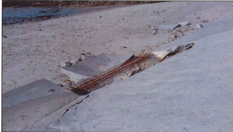
Figure 8 : Dégâts constatés en février 2018 (Source : Commune de Gâvres)
