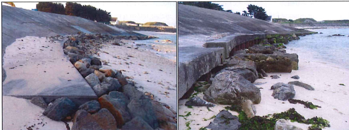
Figure 17 : Comparaison de l'état de l'enrochement en 2012 (à gauche) et en 2018 (à droite)
