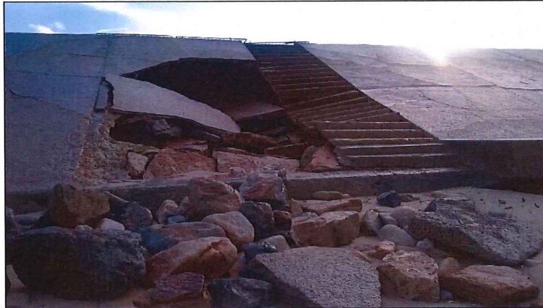
Figure 6 : Dommages constatés le 11 janvier 2016 (Source : Commune de Gâvres)
